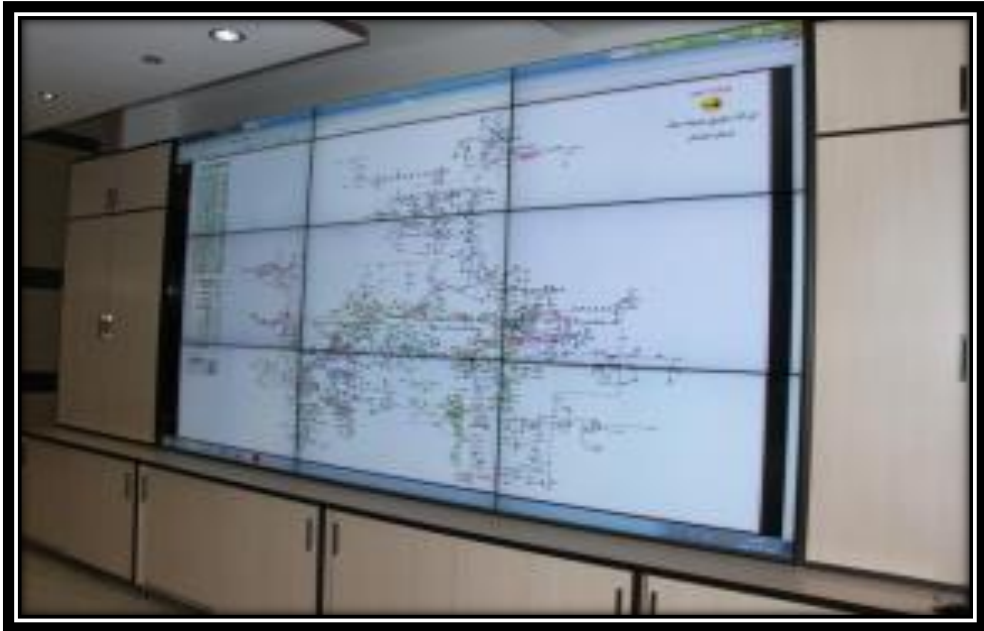
شکل (۴-۷): اتاق کنترل
